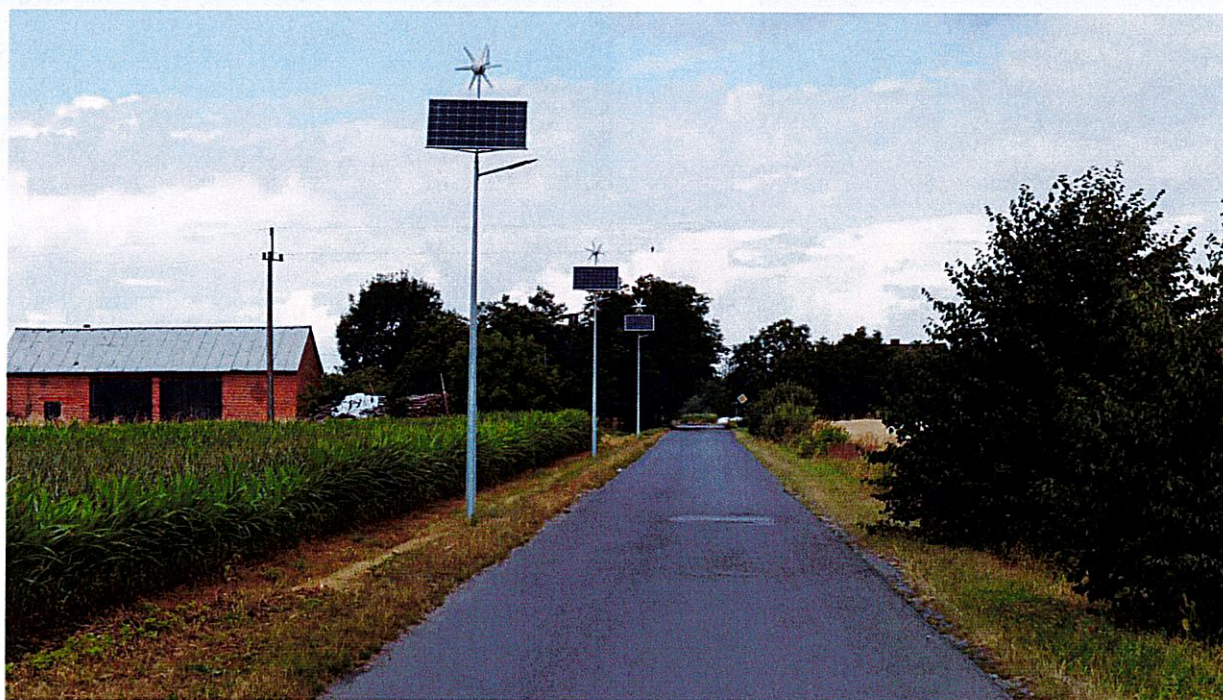
Nowoczesne oświetlenie typu LED wzdłuż jednej z dróg w Zbiersku.
